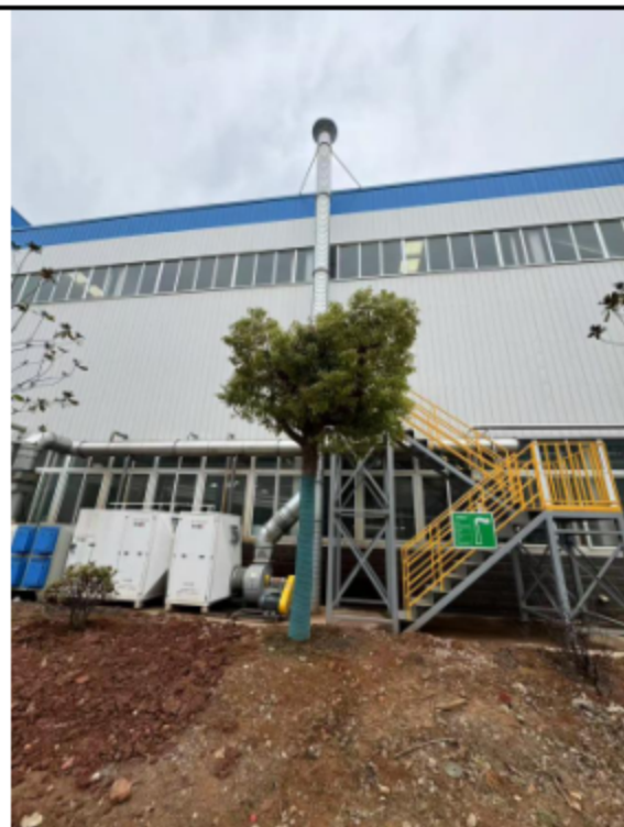
排气筒+采样平台 (DA004)
