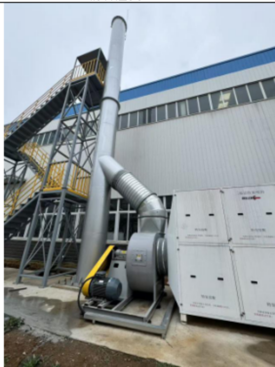
排气筒+采样平台 (DA005)
